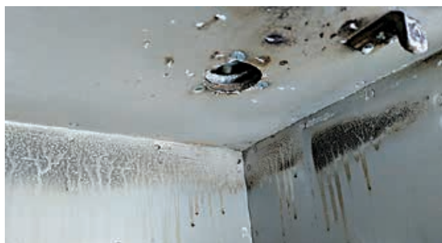
Roestresten binnenkant behuizing
