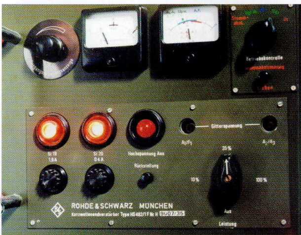
Foto 3: Signalering "Hochspannung aus"
