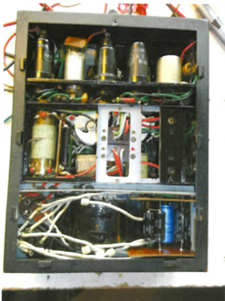
Foto 4: De onderkant van de MR 3, duidelijk is te zien dat de voeding gerenoveerd is.
