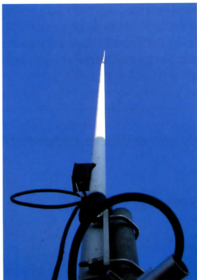
foto 1: Door een slimme rollade-ruil kon PA4URK een acht meter lange Comrod scheepsantenne plaatsen.
