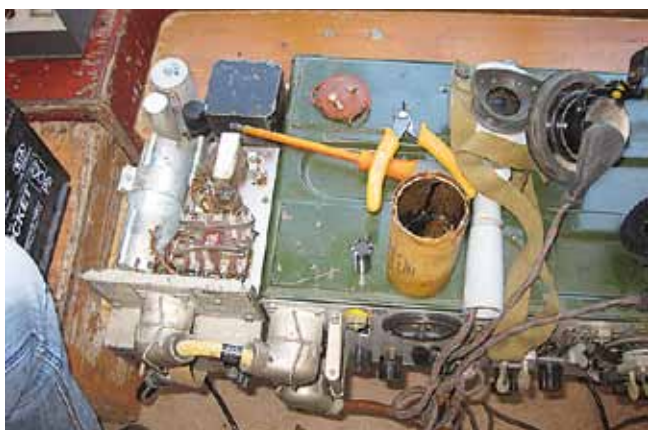
Foto 9: De ontplofte 450 V condensator in de PSU van de WS19 nadat de rook is opgetrokken
